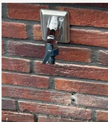
Vorstvrije buitenkraan gepositioneerd aan de achterzijde
